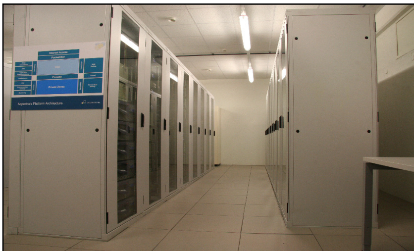
Aspectra Rechenzentrum: Plattform
