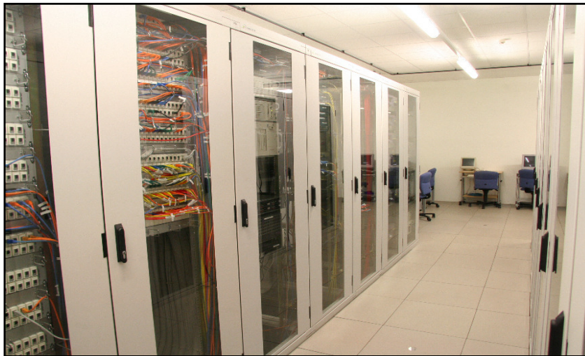
Aspectra Rechenzentrum: Plattform
