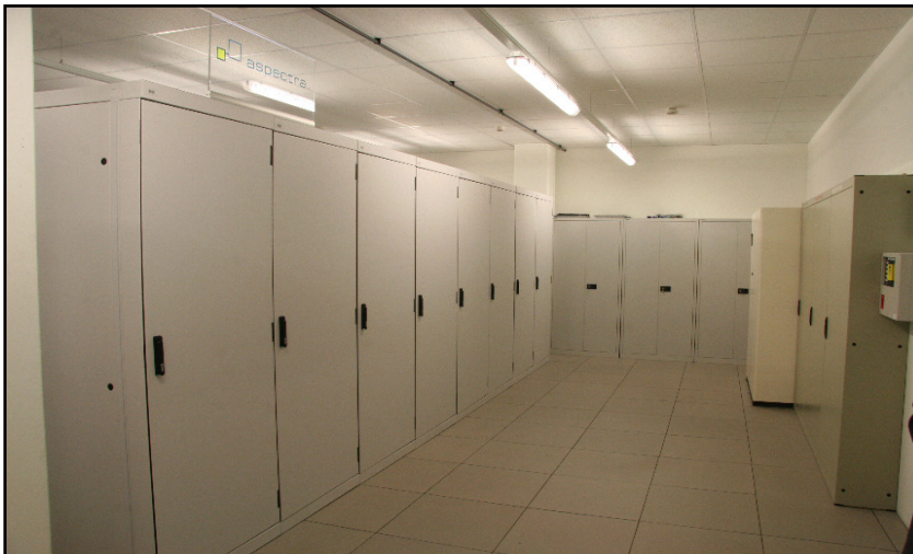
Aspectra Rechenzentrum: Kundenracks
